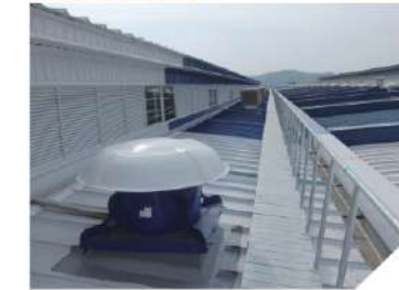
屋顶强排风设备
